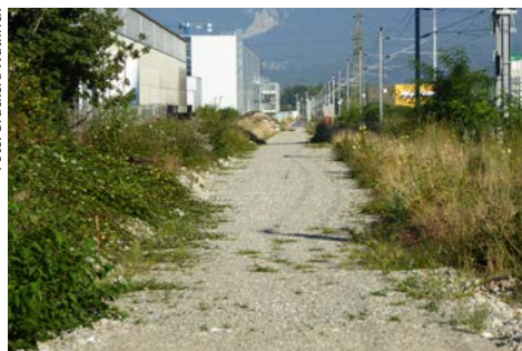
Als Verbindung vom Fadacker in Subingen zum Wissensteinfeld in Derendingen wird der 3m breite Fuss- und Radweg entlang der Bahnlinie mit einer Baumreihe gebaut.
